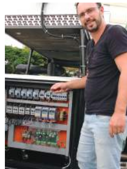
JUNIOR, DA REFRIAC. Hoje, já há mais padarias do que supermercados utilizando o sistema de propilenoglicol.
